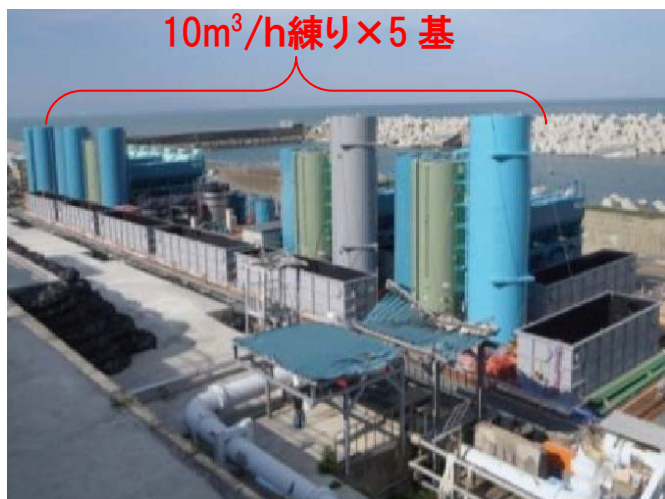
専用の製造プラント(福島第一原子力発電所構内、製造能力 50m 3 /h)
