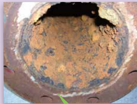
配管内部腐食状況
