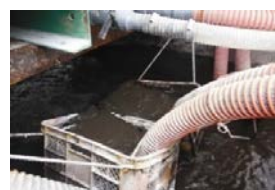
回収した泥水 (凝集剤を添加)
